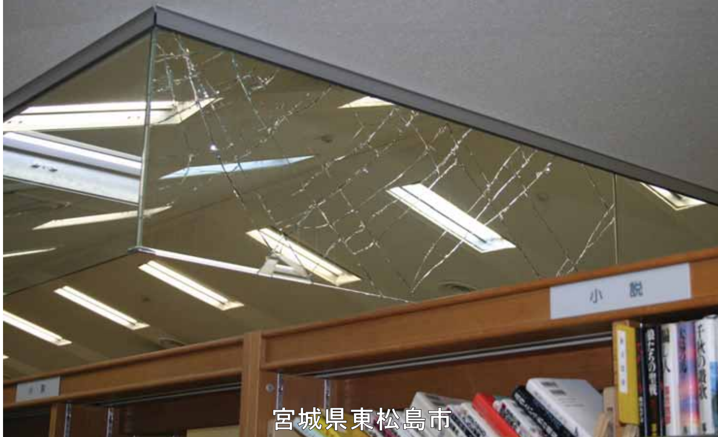
2901_2_031_038396_東松島市図書館_2011.4.8_余震被害(7日午後11:32震度6弱)
